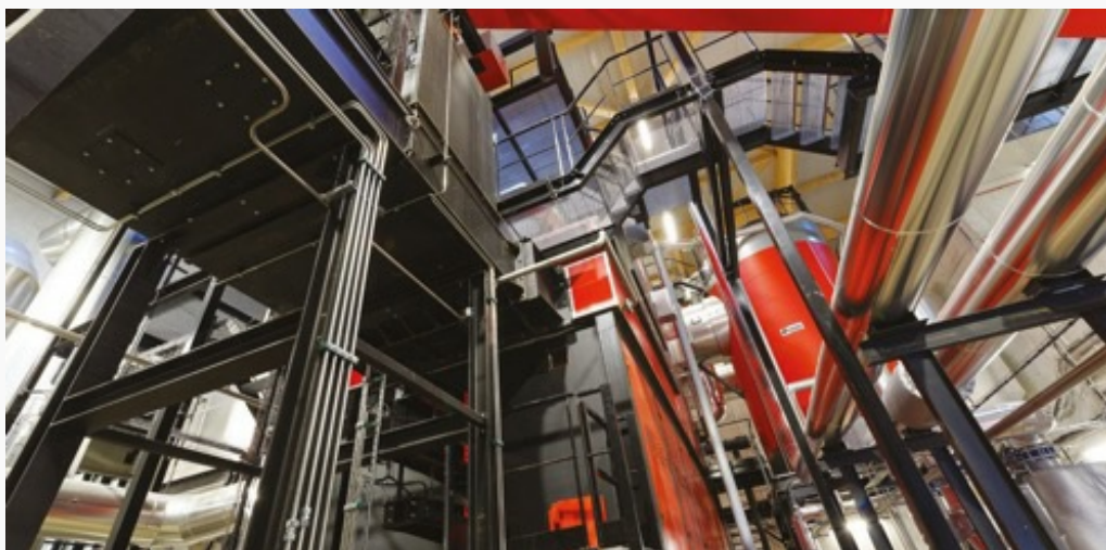
La chaudière bois Weiss de 12 MW à Brest Spernot, photo Sotraval
