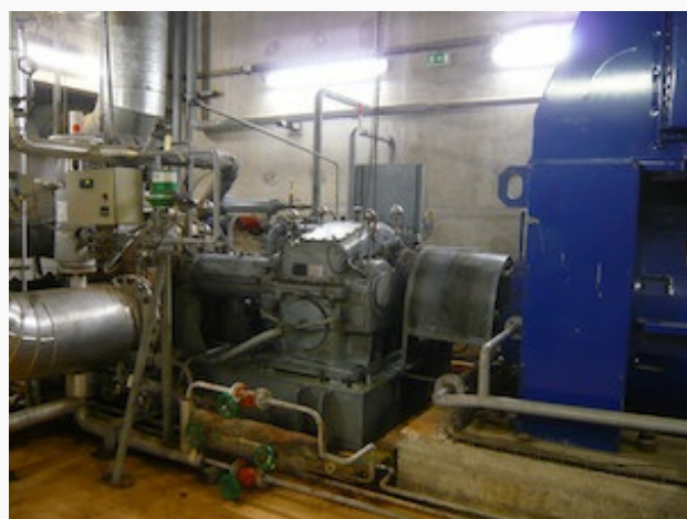
Turbine vapeur de l'UVED, photo Sotraval
