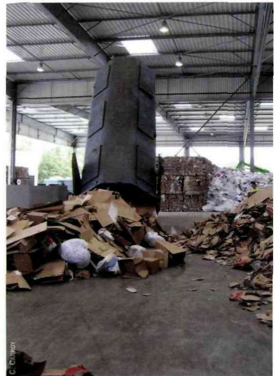
Sur 13 000 m 2 , le centre d'Écharcon reçoit jusqu'à 200 000 t/an de déchets d'activités et encombrants
