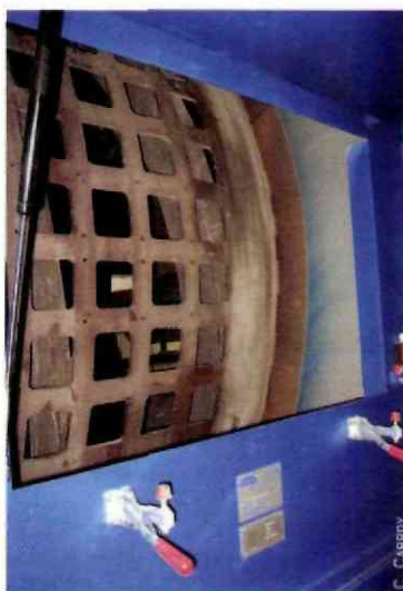
Le trommel constitue une phase classique du tri et de la préparation granulométrique d'une ligne de CSR
