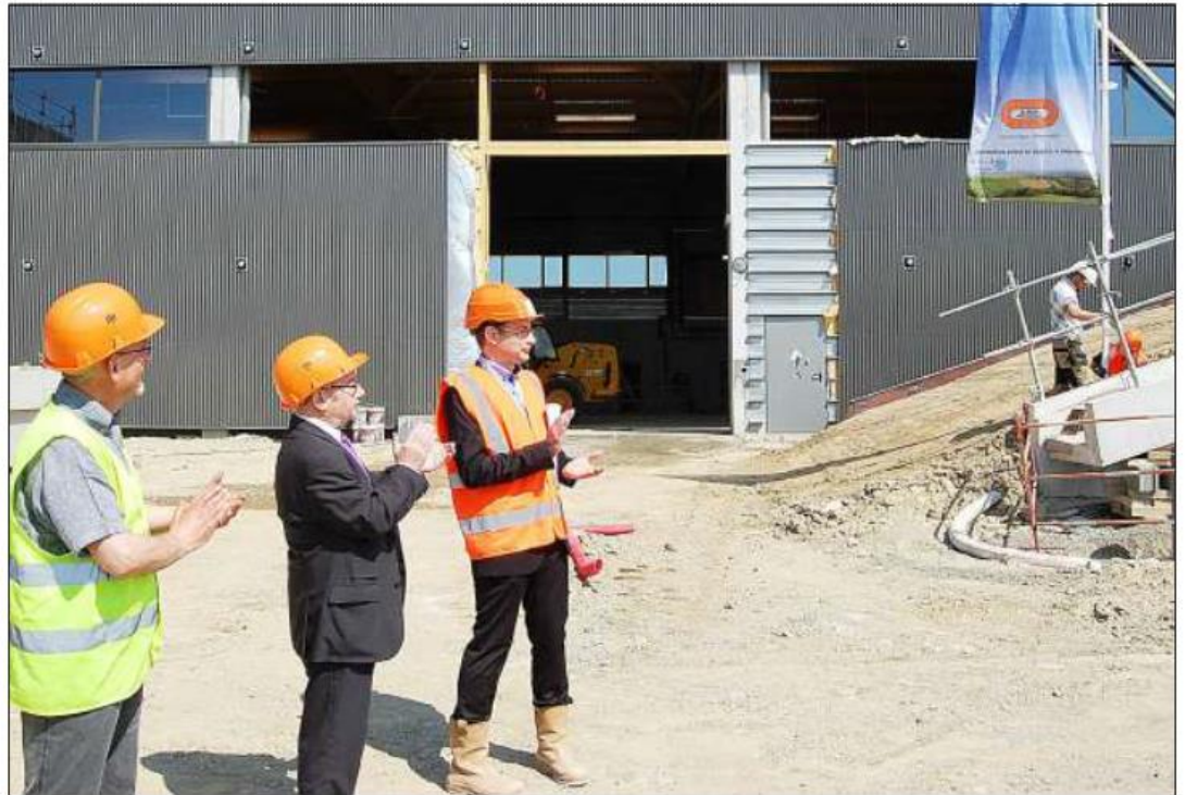
En sept mois, l'usine est presque terminée et le chantier a reçu, hier, le label bleu pour la qualité de ses travaux.
